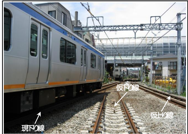
写真⑤ 星川4号～6号踏切間軌道敷設状況 (星川4号踏切付近より海老名方面を望む)
