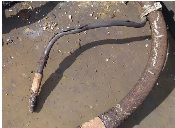
被覆を残して断線・溶損した電線
