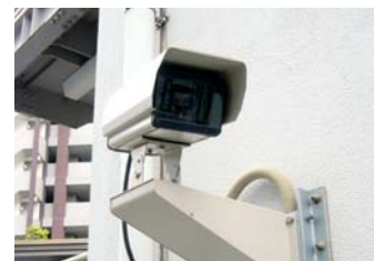
変電所の防犯カメラ
