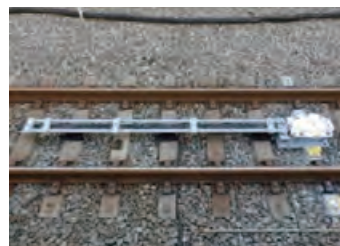
ATS-P 地上設備
