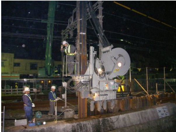
天王町1号踏切付近で進めている護岸防護工事 線路が帷子川に近接するため地盤の補強し護岸 を防護するもの（平成18年11月撮影）
