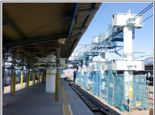
写真-② 星川駅1～3番線間鉄骨架設状況 （下りホーム横浜方から海老名方を望む）
