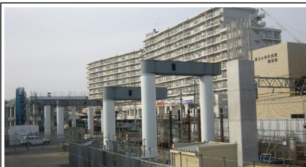
写真-② 天王町第3号踏切付近鉄骨架設状況 （横浜方から海老名方を望む）
