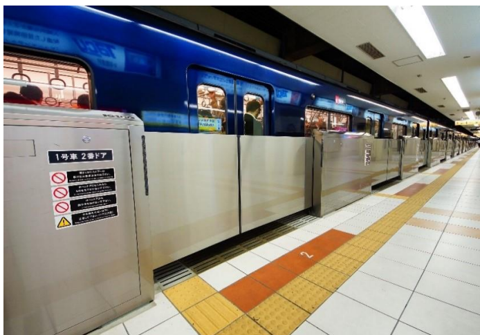
相鉄線 横浜駅に設置したホームドア
