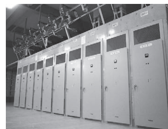
二俣川変電所の直流高速度遮断器
