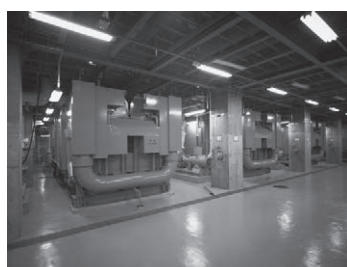
第1エネルギーステーション
