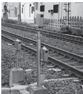
踏切自動障害物検知装置
